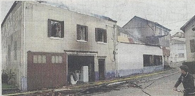
■ Menaçant de s'effondrer, la maison, contiguë à la droguerie où le feu a pris, sera démolie un peu plus tard mercredi. Photo Sylvie Silvestre
